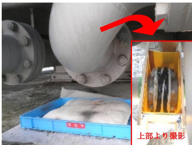
変圧器下部フランジ
