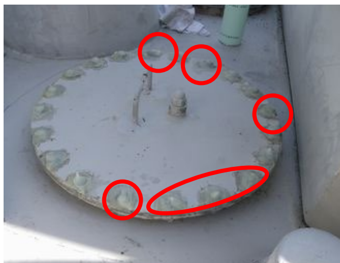
変圧器ハンドホールNo.1
